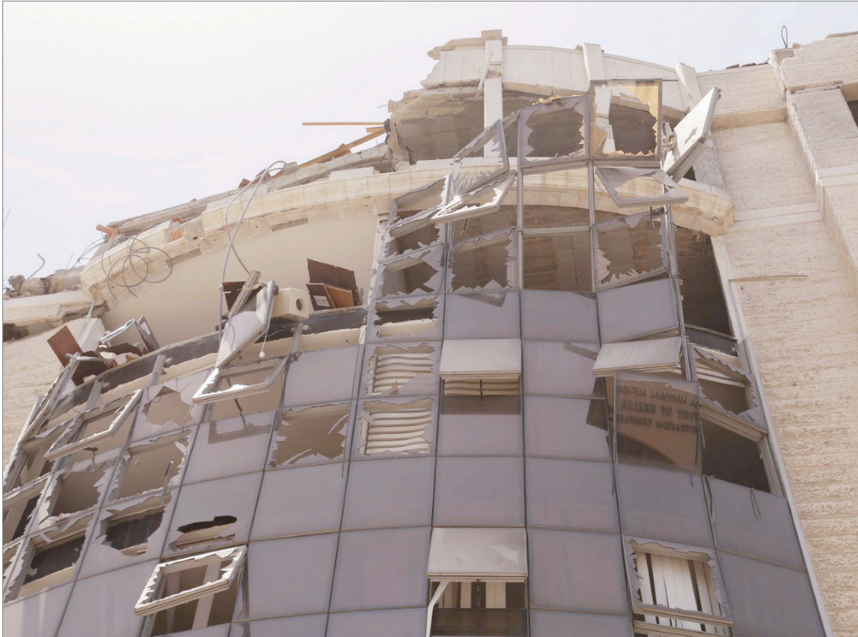
■ مبنى مقر مكتب الهلال الأحمر القطري في غزة بعد هدمه
