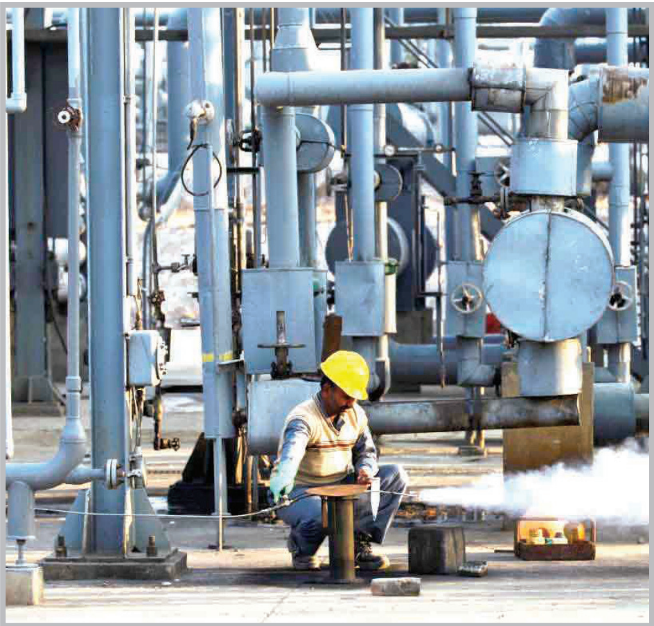
■ المستثمرون الصينيون يركزون على مشاريع توليد الكهرباء والبنية التحتية
