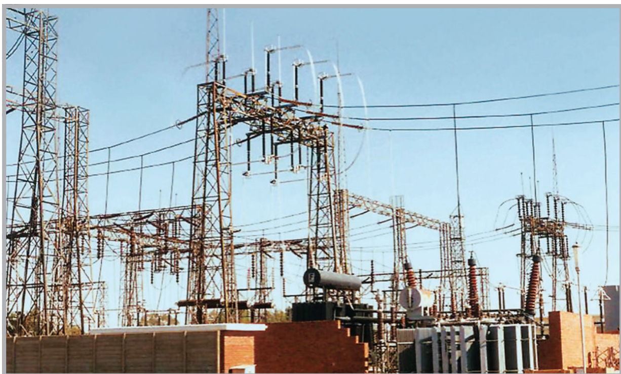
■ مشروع نقل شبكة الكهرباء، يوفر الطاقة لمدة 30 عاما
