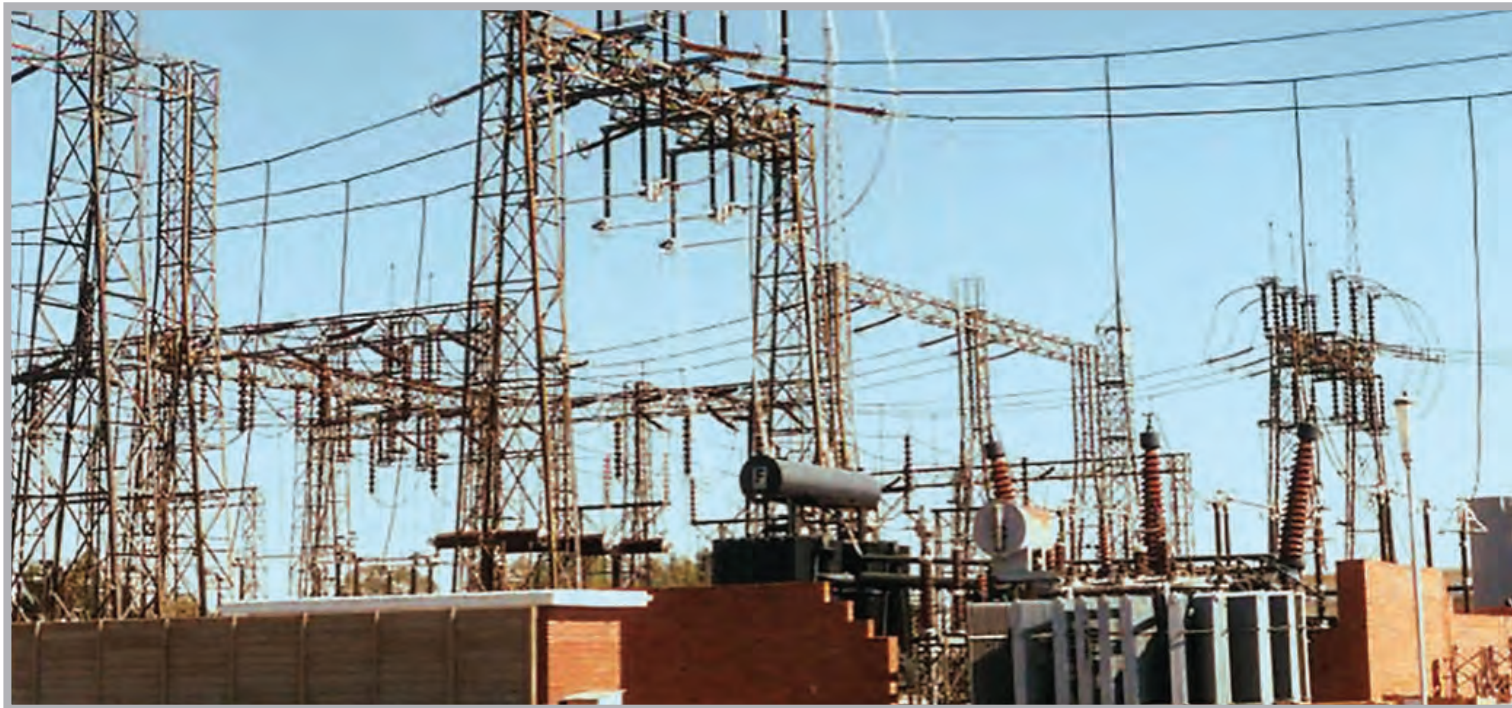
■ الربط الكهربائي بين دول الخليج نجح في تجنب الانقطاعات بمعدل 100% ، رغم ارتفاع الأحمال خلال صيف 2015م
