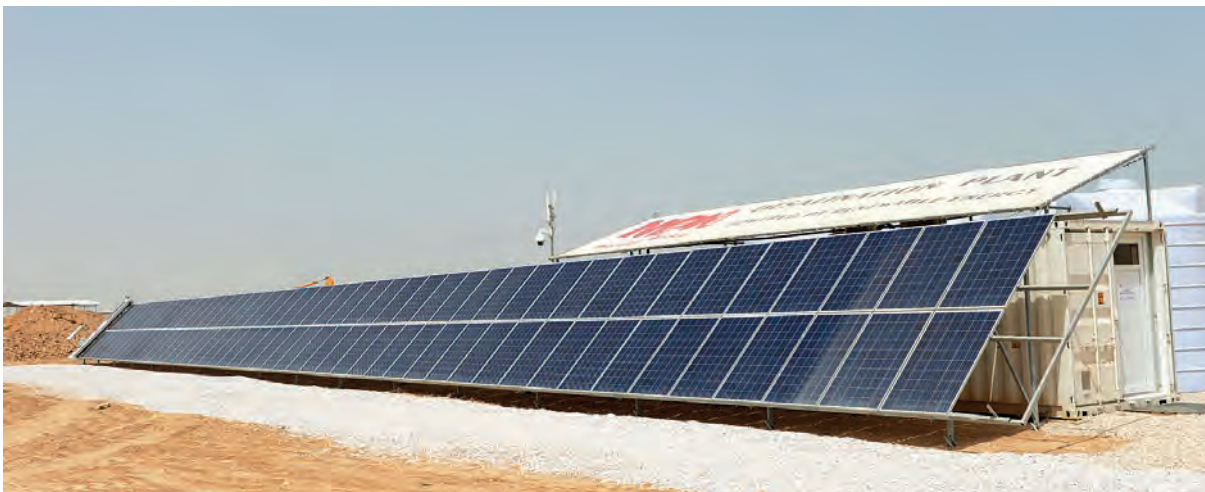
■ محطة تحلية المياه عبر الطاقة الشمسية
